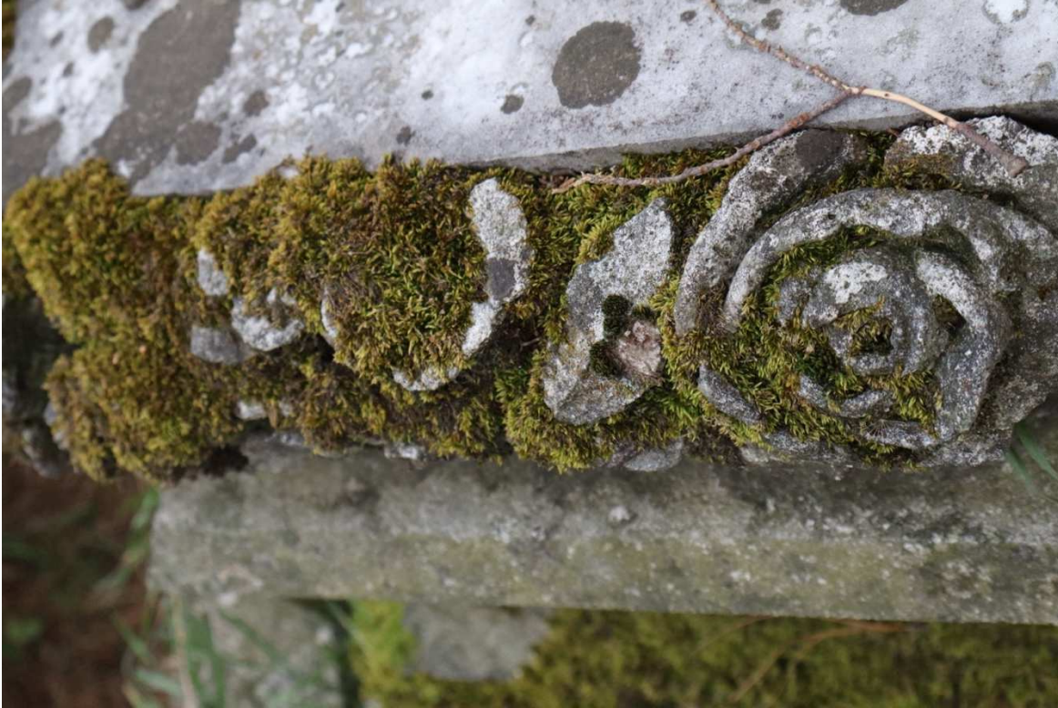
Figura 23. Detalle de tumba con humedad en Panteón Inglés.
