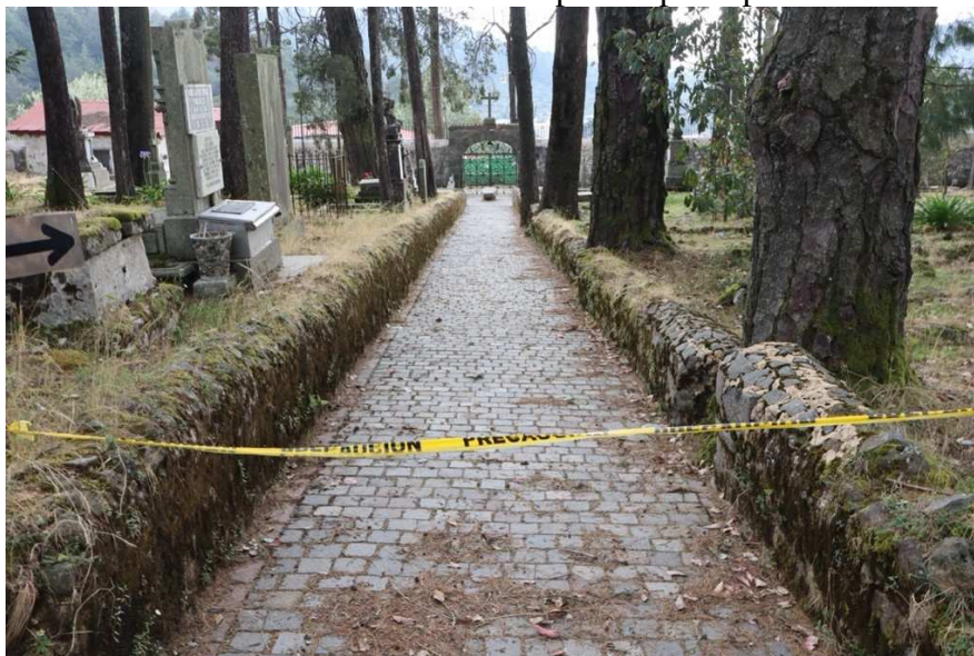
Figura 22. Detalle de deterioro en bardas en pasillo principal del Panteón Inglés.
