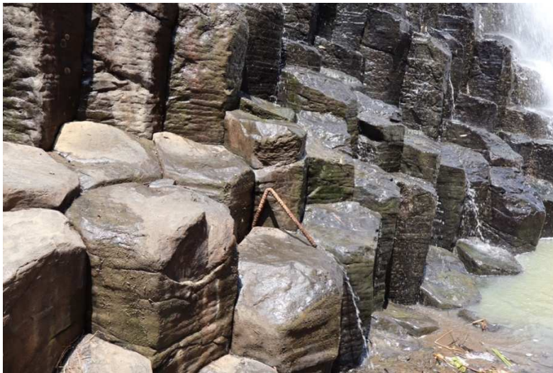
Figura 33. Varilla oxidada instalada en una intersección de los Prismas.
