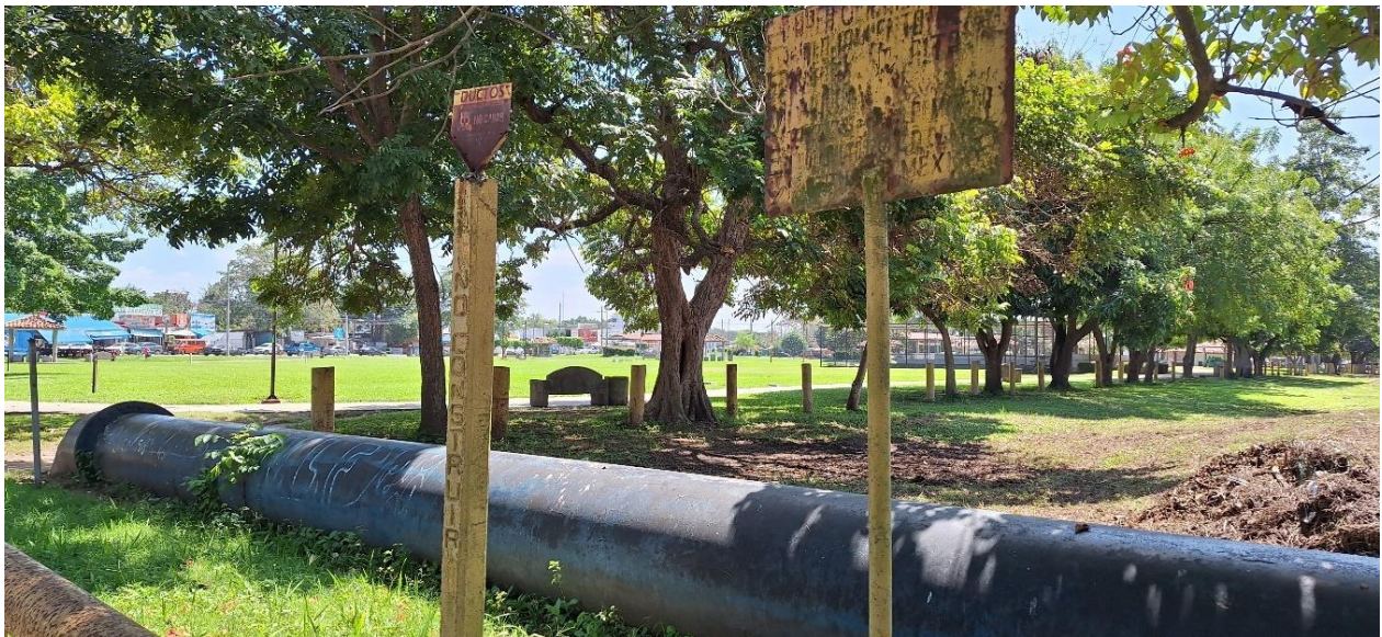
Ilustración VI.6. Ductos y tuberías que atraviesan el parque de Saloya, Villahermosa. Fuente: fotografía propia.
