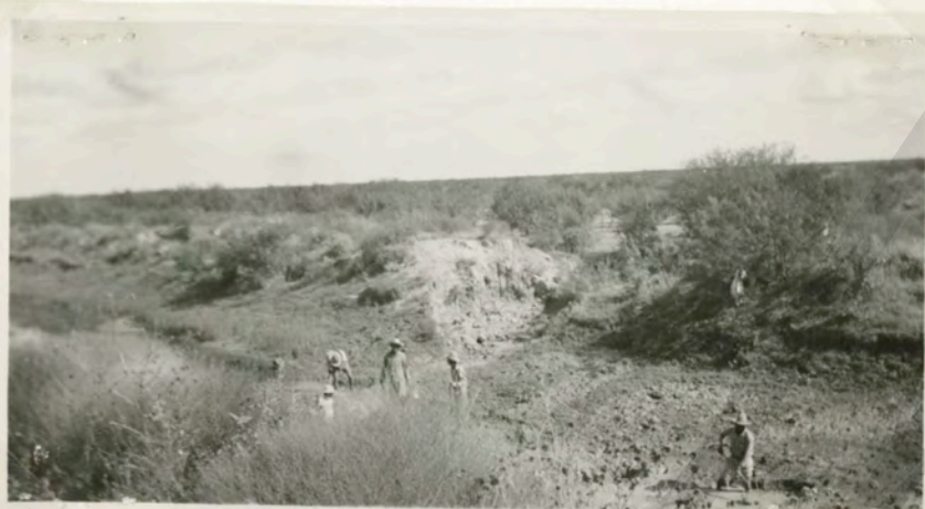
S4-8 Estado en que se encontraba el Canal Principal en la Cuarta Unidad después de la larga temporada de sequía. La foto corresponde a una cuadrilla entregada a la reparación y limpieza del canal.
