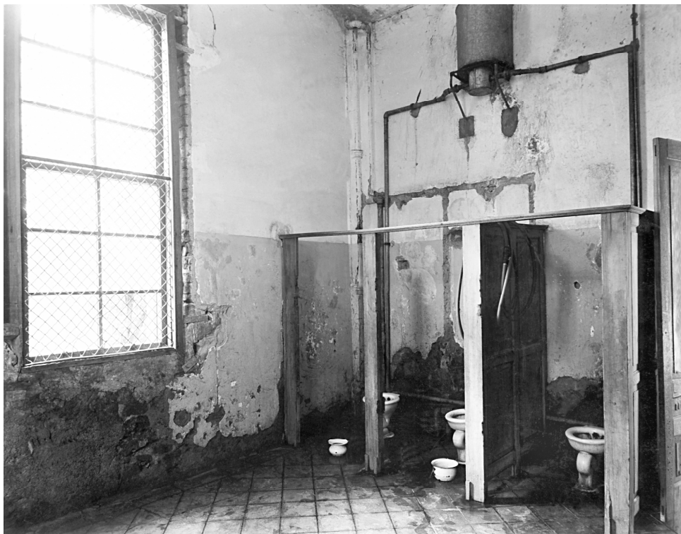
Foto 8. Deteriorados baños del Manicomio. Fototeca INAH, Fondo Culhuacán, inv. 460824
