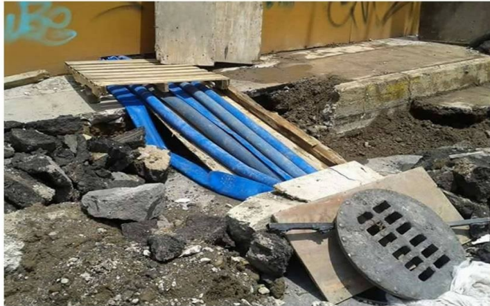
Mangueras de 4 pulgadas para tirar el agua de todos al drenaje sanitario
