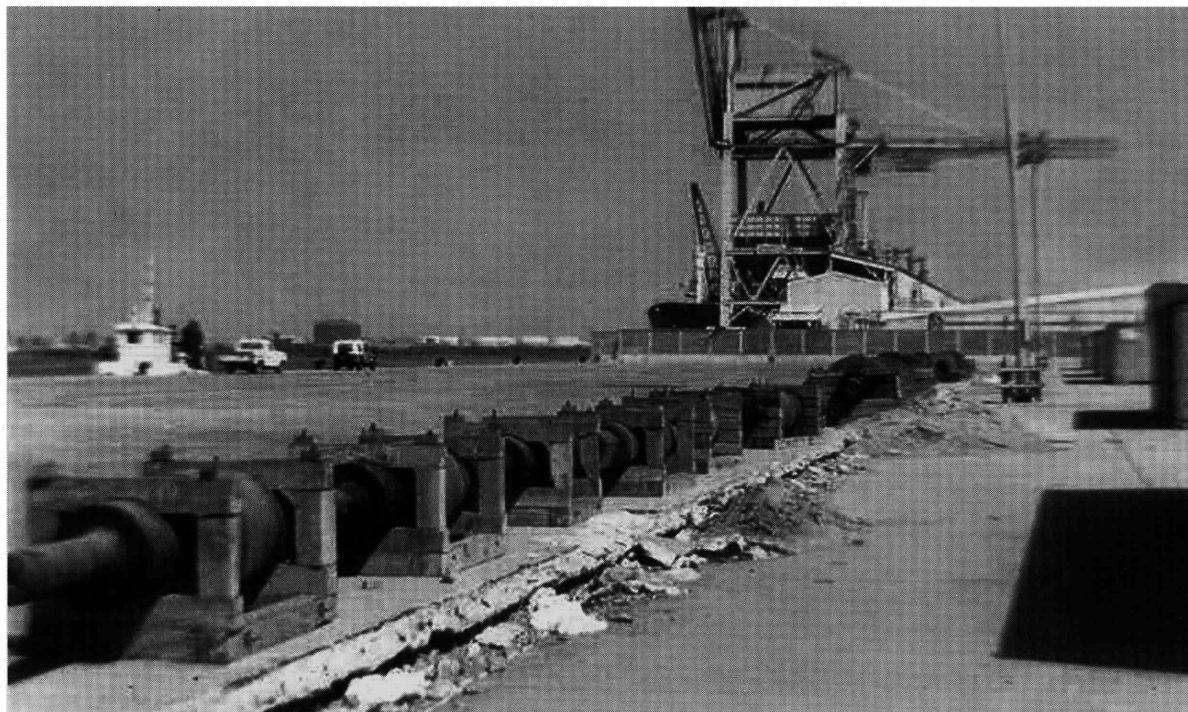
FIGURA 9b. Licuefacción del suelo y hundimiento del piso en la terminal de usos múltiples en Lázaro Cárdenas, 19 de septiembre de 1985.
