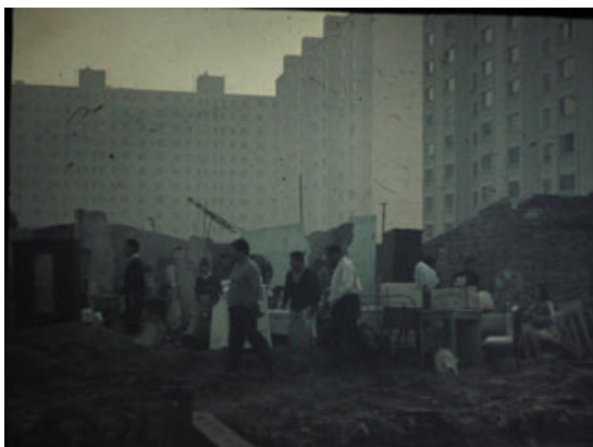
Imagen 41. "Efectivos militares trabajan en la demolición de una villa, en Villa Lugano", Buenos Aires, [1968-1970].
