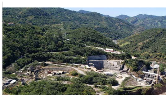
Ilustración 1 Central Hidroeléctrica “El Chaparral”
