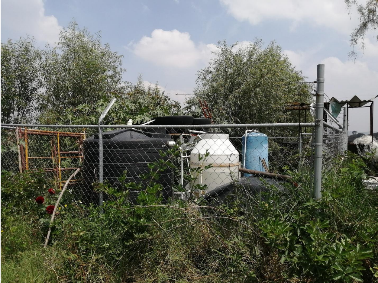
Fotografía 6.3: Sistema de purificación de agua sin acceso a electricidad
