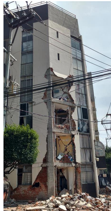
Figura 4.1.1. Fotografía del edificio después del sismo
