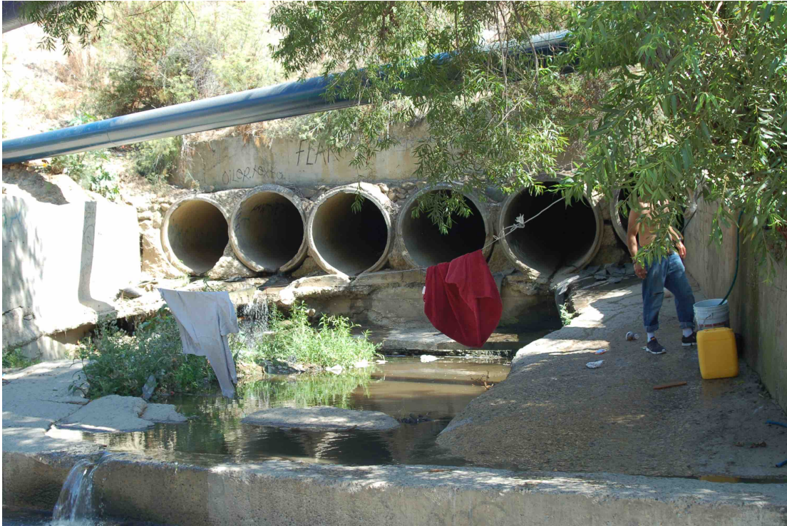
Fotografía 10 Paso de desagüe pluvial en el Cañón de los Laureles
