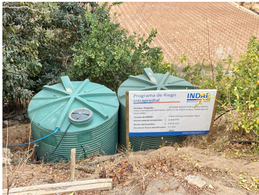
Imagen 16. Sistema de riego por goteo ejecutado por INDAP, Paihuano. Julio 2022.
