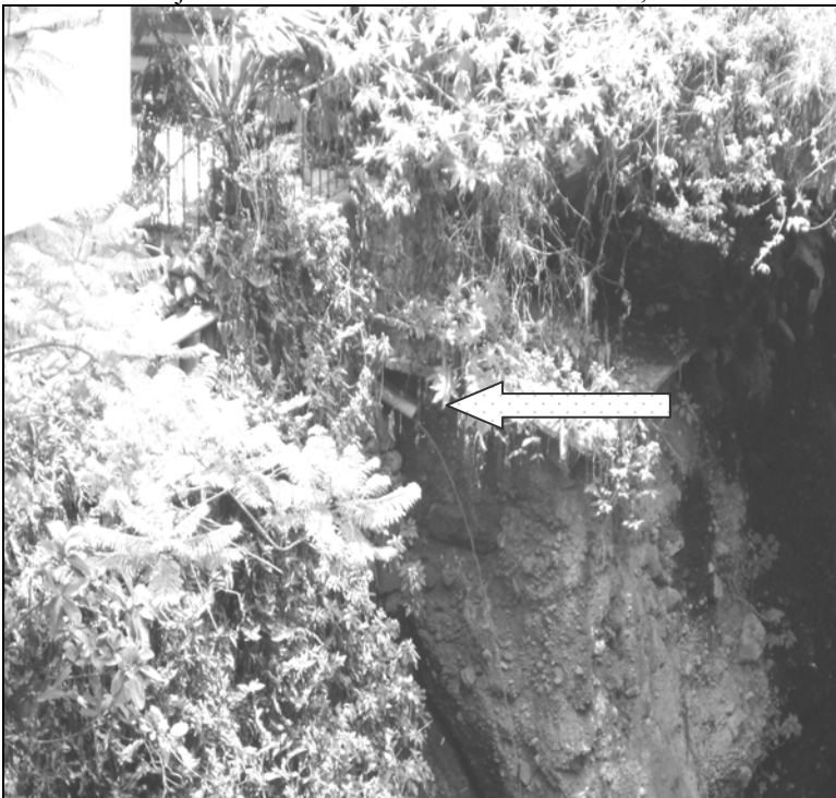
Foto 11. Drenaje conectado a la barranca de Amanalco, en Cuernavaca.
