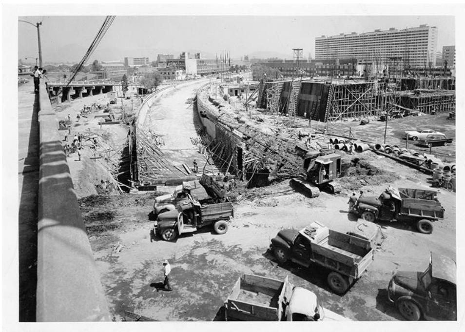
Imagen 15. Panorámica de la construcción del paso a desnivel en el antiguo puente de Nonoalco. Fuente: Conjuntos Habitacionales, CUPL-Nonoalco Tlatelolco, FCI_UHNT_01, Colección ICA Acervo Histórico Fundación ICA, A.C.
